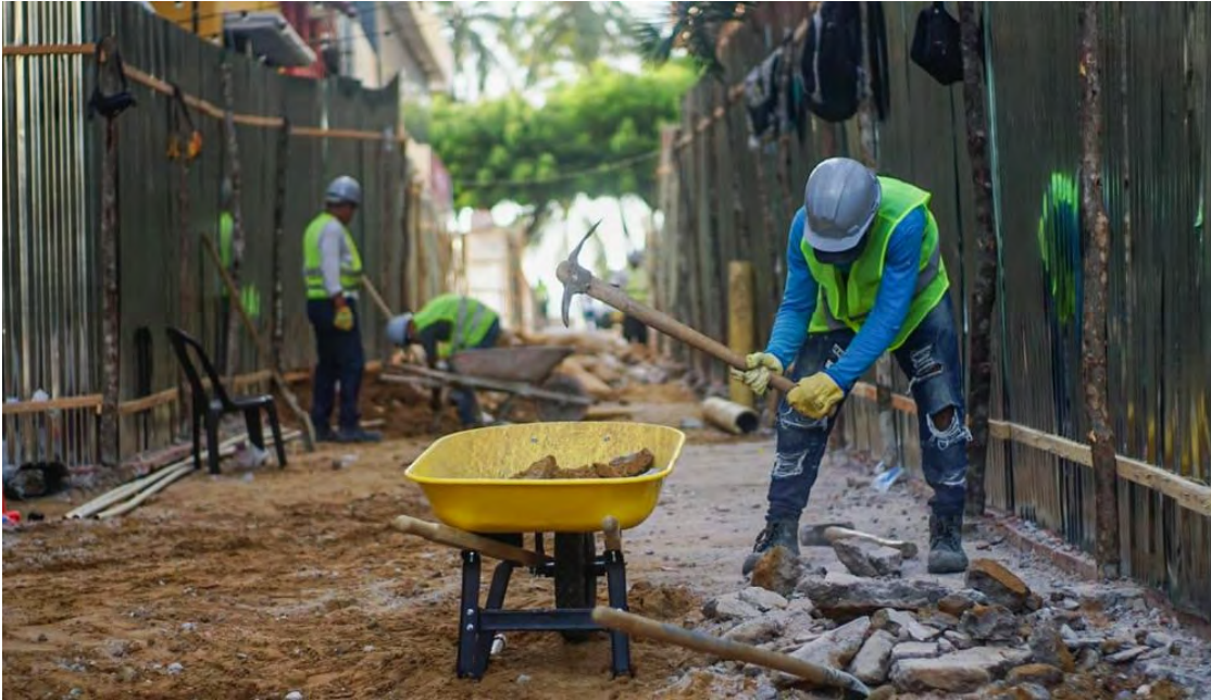
Las obras de remodelación del Callejón de Las Brisas contará con una inversión superior a los 600 millones de pesos.
