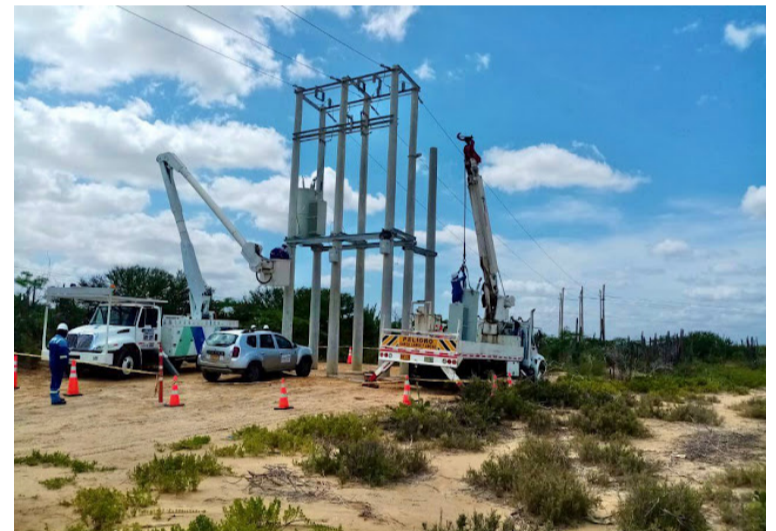
Se han adecuado 10 kilómetros de la línea con la instalación de 100 postes y 30.000 metros de redes.
